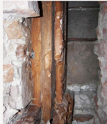
Stark geschädigter Fuß eines Bohlenbinders ◀
