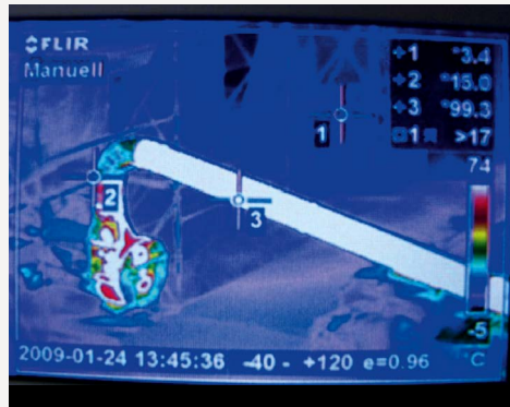
Thermografische Aufnahme des Heizluftgerätes ◀
