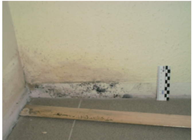
Typische Schimmel-Situation in einer Raumaußenecke hinter den Sockelleisten
