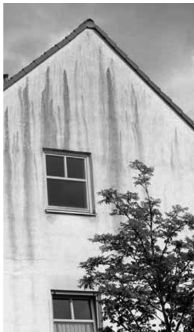
Abb. 6 Algen an einer Fassade mit geringem Dachüberstand
